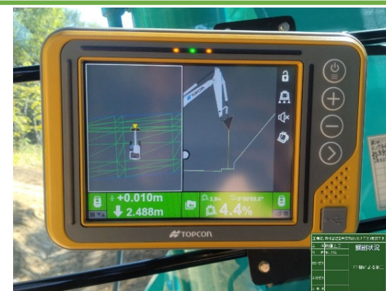
コックピット内のモニター状況
