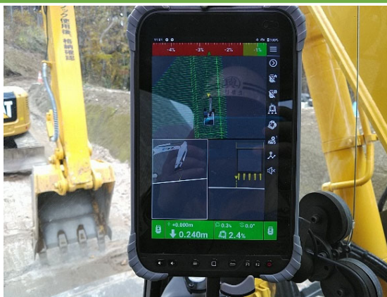
コックピット内のモニター状況
