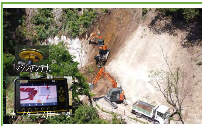
ICT法面掘削機による作業状況 通常のMGバックホウも併用
