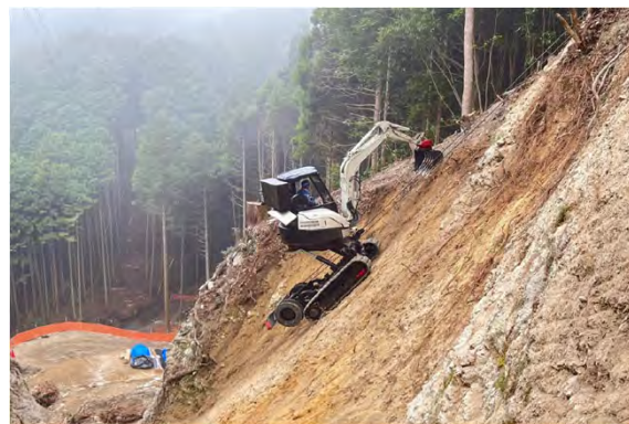
現地状況（ロッククライミングマシンが必要なほど急峻）
