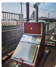
薪ボイラー(上)と薪ストーブ(右)
