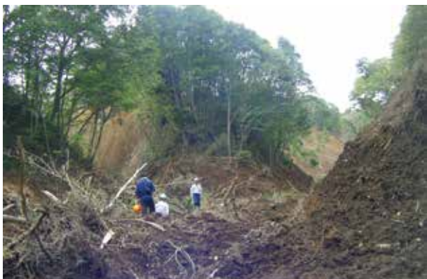
溪流内の崩積土、危険木の状況
