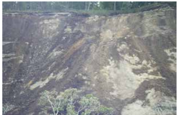
法枠上部の崩壊状況
