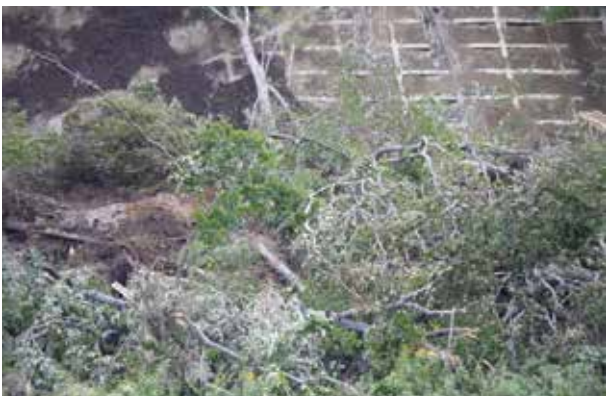
崩壊土砂は少なく、立木が堆積している状況
