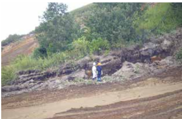
谷地形崩壊箇所の側壁
