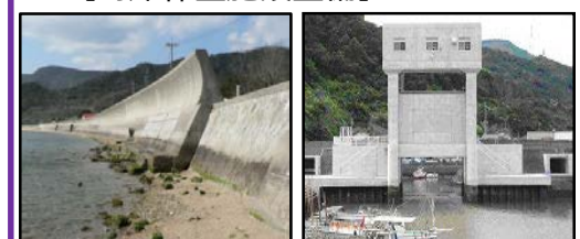
津波、高潮による被害を未然に防ぐため海岸堤防の整備を推進 津波・高潮対策としての水門整備
