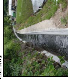
老朽化した用水路の整備・更新
