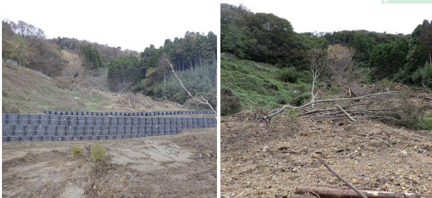
令和6年能登豪雨による被害と応急対策の実施
