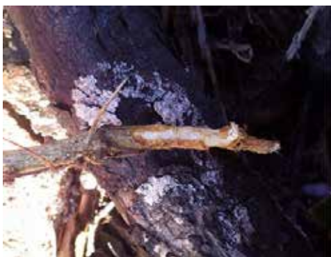
写真 4 - 4 8 ネズミによる食害跡 （平成 30（2018）年 12 月）
