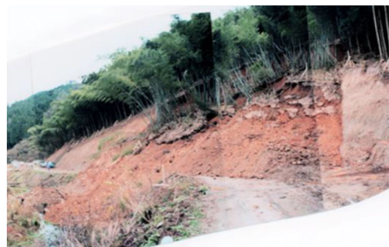
図32 移動体脚部の切土から崩壊した事例
