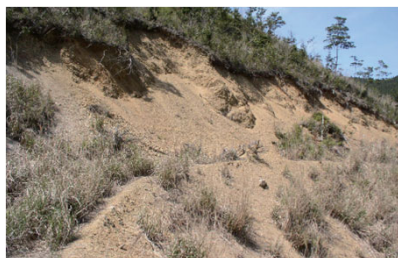
図2 切土法面の崩壊
