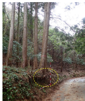
図42 崩壊を抑止する機能を果たしている可能性がある立木の例
