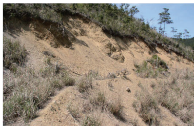
図2 切土法面の崩壊
