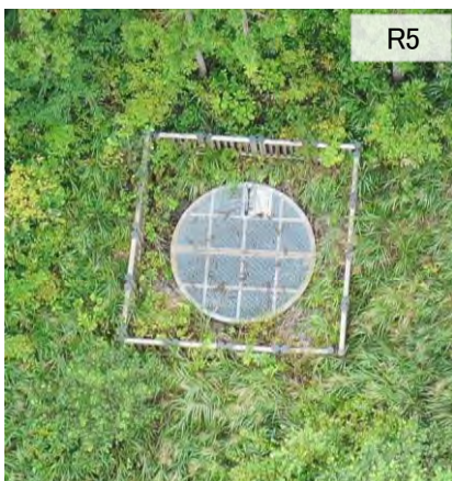
【③産女川区域 集水井】
