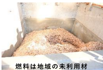
バイオマスボイラー棟を見学
