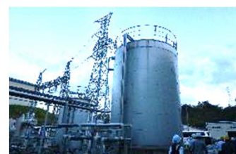
真庭バイオマス発電所
