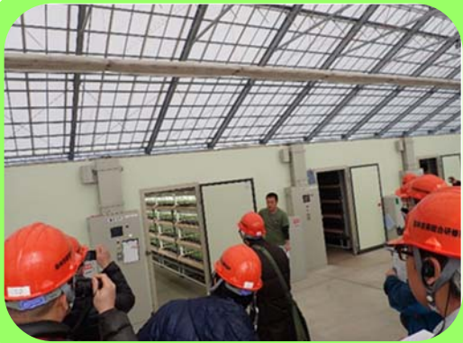
次世代施設園芸ペレットボイラー(重油混焼) トマト苗木育苗庫
