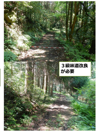
路盤が脆弱、舗装が薄い
