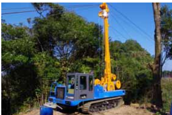
横取り可能なタワーヤード
