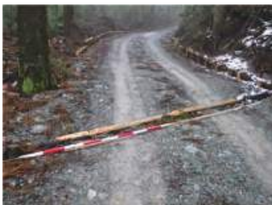
2本の丸太を使用した横断排水施設
