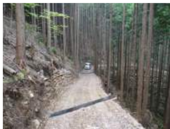
ゴム板を使用した横断排水施設 (上流から望む)
