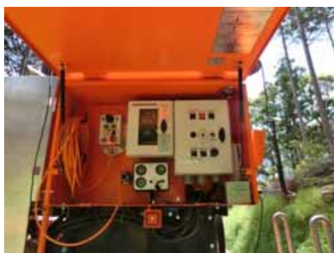
タワーヤード本体に設置された制御盤
