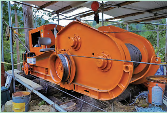
設置された集材機
