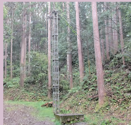
鋼製の人工支柱
