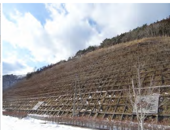
写真 6-5 鷹生ダム付近の法面の様子 (2 月 4 日)
