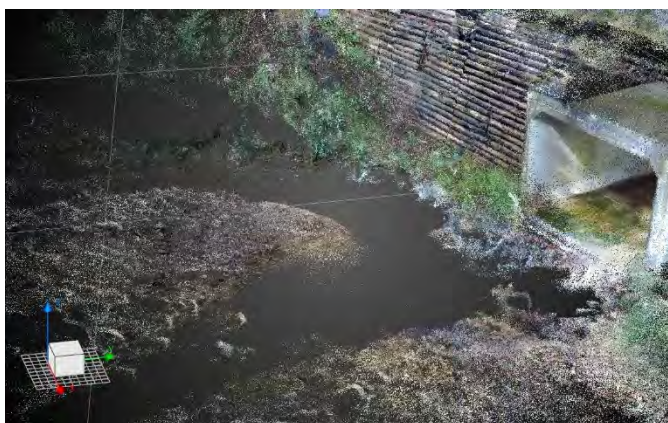
図 1-2 流水部が欠損している事例
