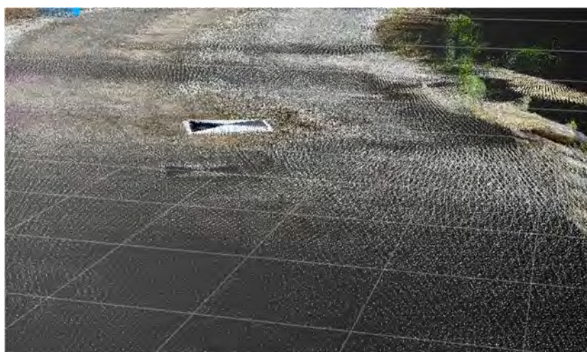
図 1-3 路面が2重になっている事例
