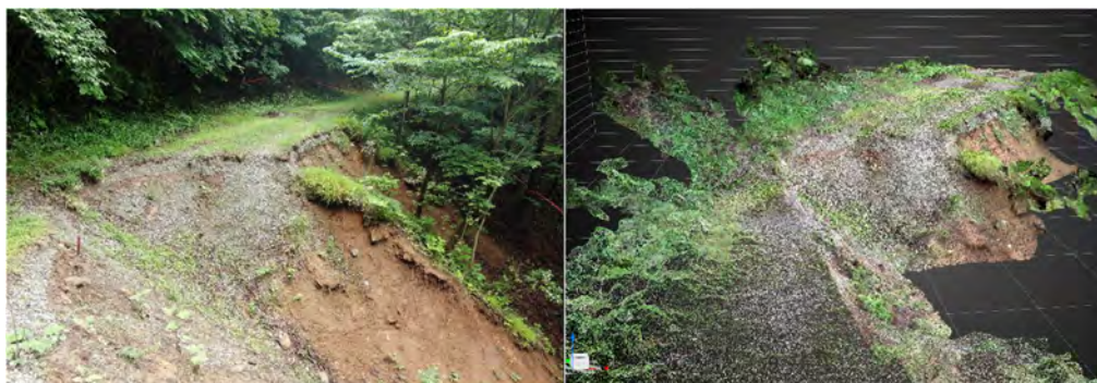
写真 4-4 林道被災箇所の写真
