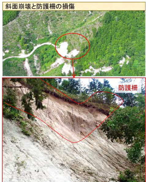
図—1 真砂土地域の斜面崩壊による防護柵損傷箇所
