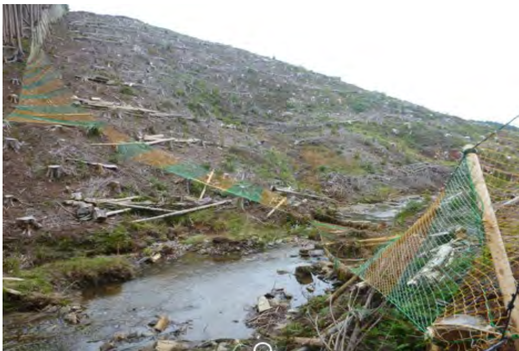
写真 7 平成 30 年 10 月 台風による損壊
