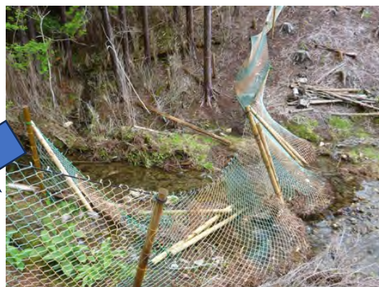
写真 3 平成 30 年 5 月 大雨で変形
