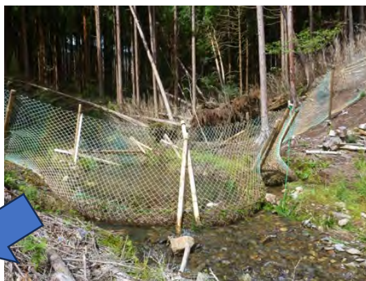
写真 5 平成 30 年 9 月 台風で変形
