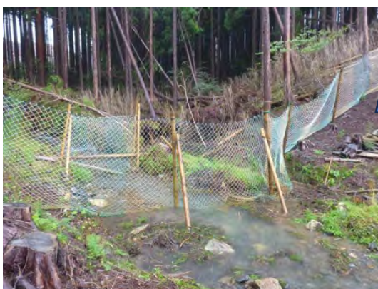
写真 6 平成 30 年 9 月 2重柵で修復
