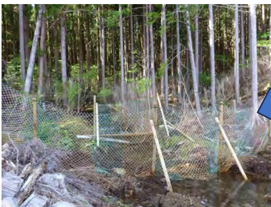
写真 4 平成 30 年 5 月 2重柵で修復
