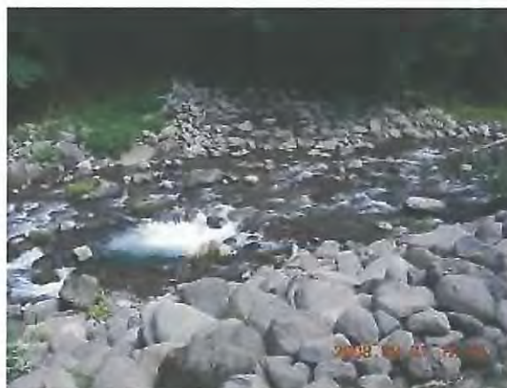
写真 4-1 赤イ川 H18 改良治山ダム (No.11)
