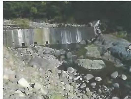
イワウベツ川調査区間上流端 治山ダム(No.7) 5号コンクリートえん堤
