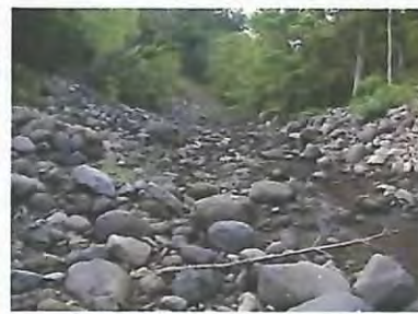
橋脚上流を望む。 土砂が押し出した状況。
