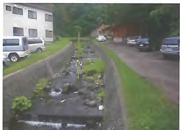
流路工中間部の状況。横工による落差が生じている。
