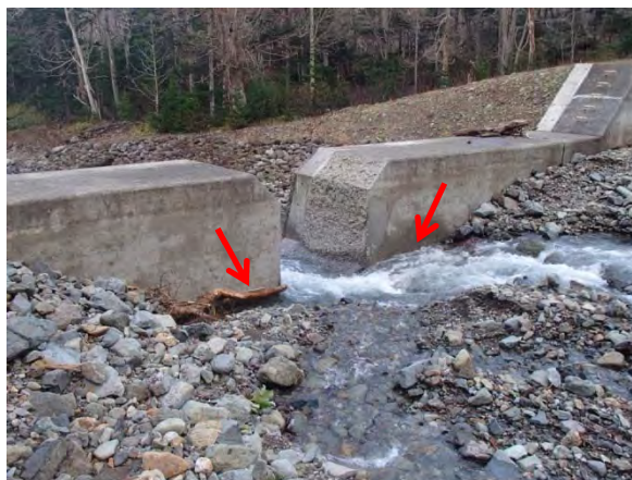
出水後の状況 (11月15日)
