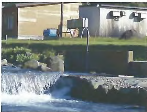
写真 2-6 岩尾別ふ化場横の塩ビパイプ (塩ビパイプの中に水位計設置)
