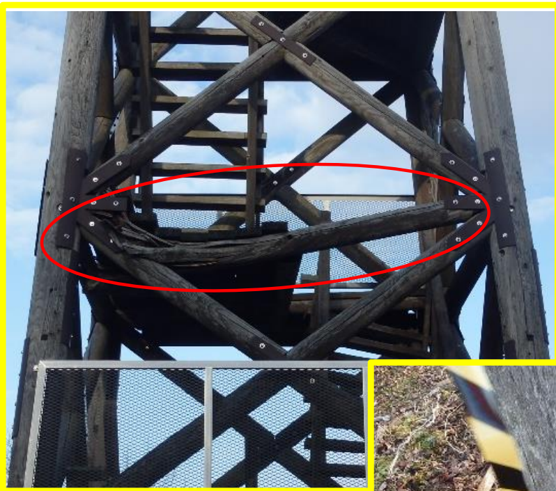
梁の腐朽状況
