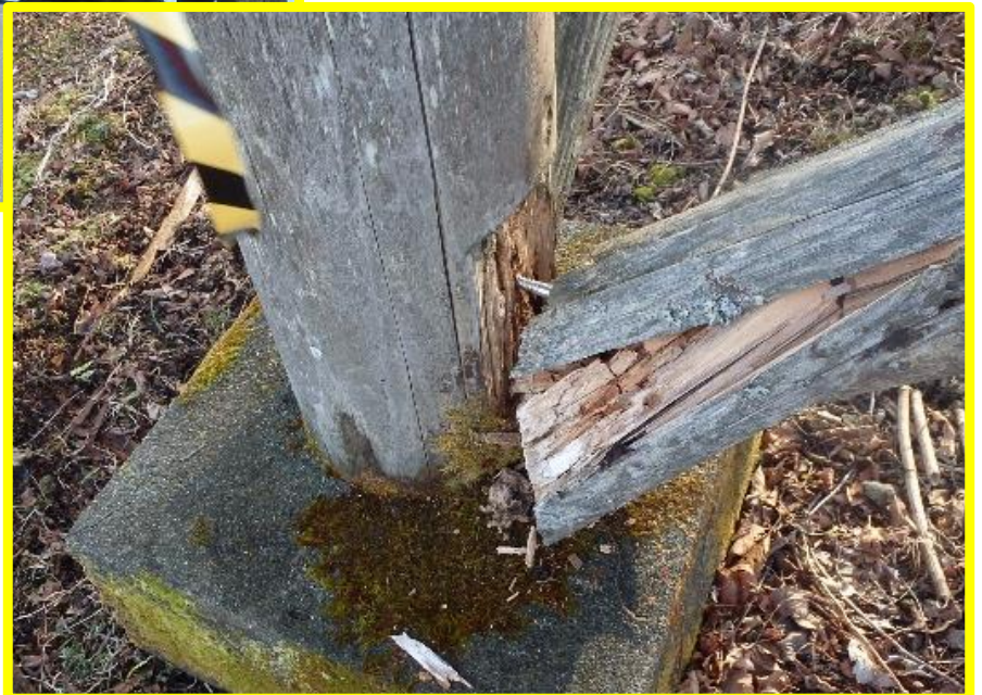
基礎部の腐朽状況
