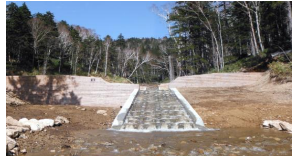
魚道を配置した治山ダム (熊見の沢 69林班)
