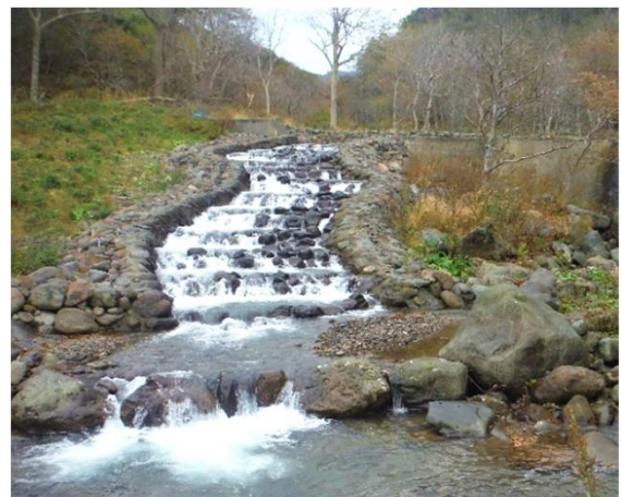
石組み魚道工 (斜里町ウトロ地区フンベ川)
