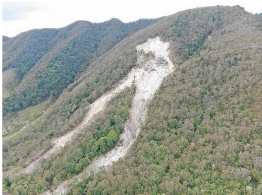
滝波谷区域の山腹崩壊状況(岐阜県関市)
