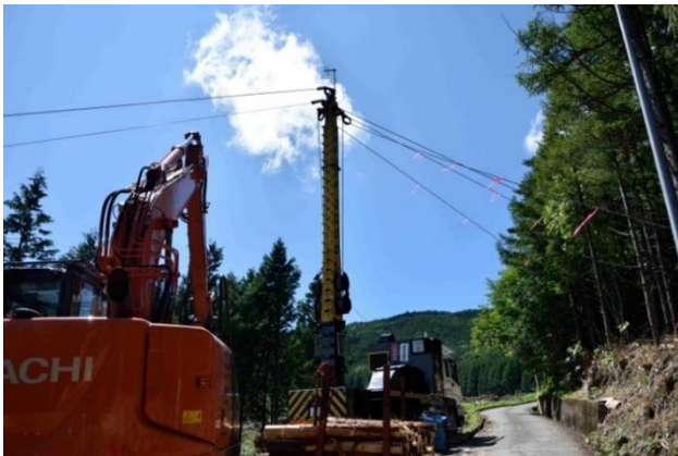
(タワーヤード)
