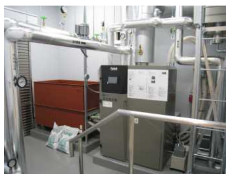
南木曽支署(ペレットボイラー)
