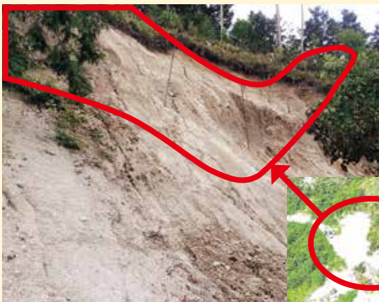
真砂土地域の防護柵の損傷状況
