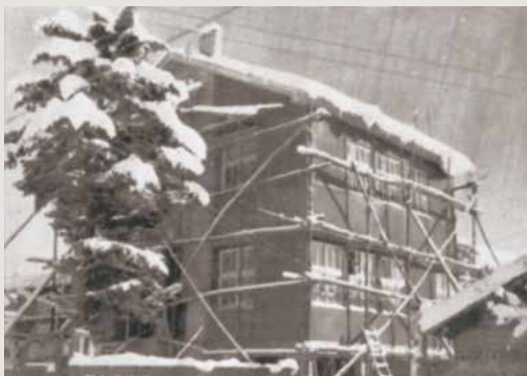
昭和30年頃、雪に覆われる建設中の飯山営林署庁舎（北信森林管理署の旧庁舎）
