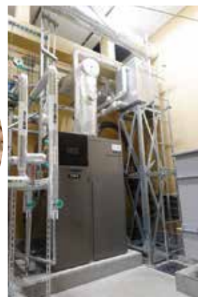
ペレットボイラー
