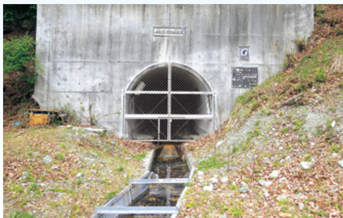
地すべり活動を抑制する排水トンネル
