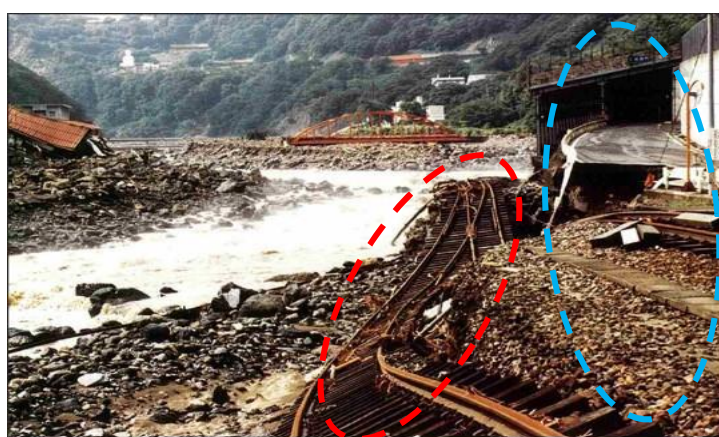
姫川の氾濫により寸断された国道 148 号と JR 大糸線
