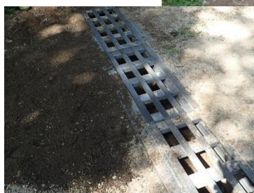
(写真下) 土砂が除去された横断溝
