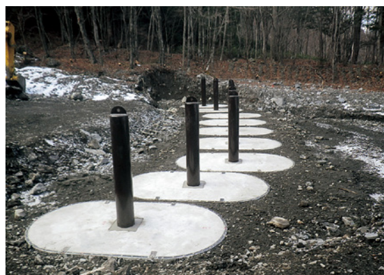
局独自開発した「流木捕捉工」 (中信森林管理署管内シシ沢)
