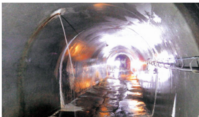
地すべり抑制のための直径約2.5m、延長約900mの排水トンネル（直轄地すべり防止事業）
