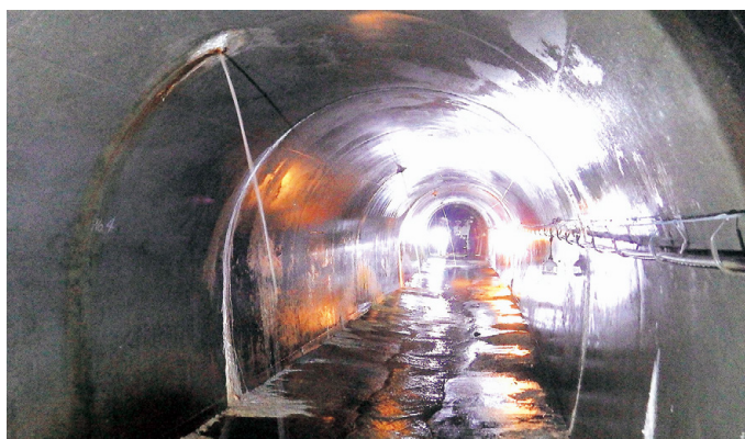
地すべり抑制のための直径約2.5m、延長約900mの排水トンネル（直轄地すべり防止事業）
