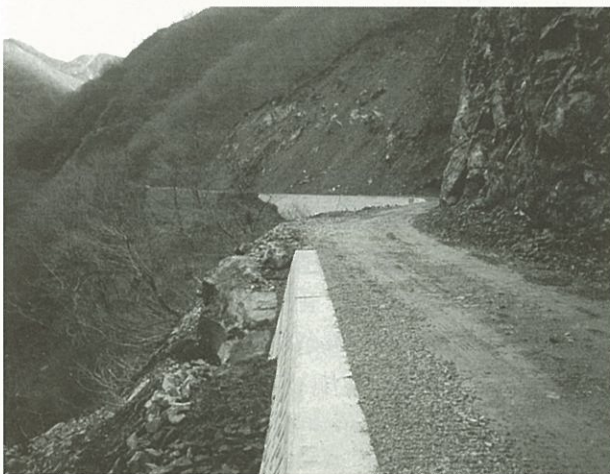
〔富山署〕 相ノ又（資材運搬路新設外1） (施工者：富建設株式会社)
