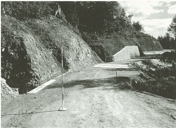
〔木曾署〕 大水無保安林整備作業道作設工事 (施工者：株式会社梅田組)
