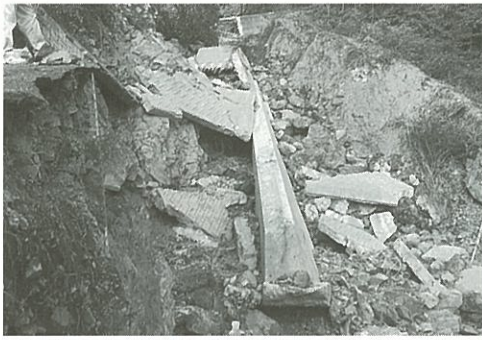
椋原谷足打谷林道（岐阜署）の林道流出現場
