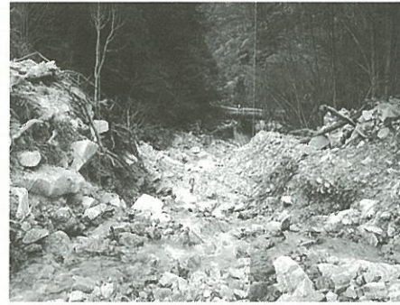
大白河地区（中信署）の溪岸の被害状況
