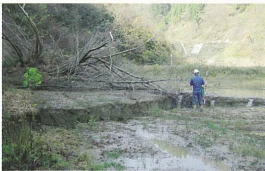
地震による地割れの状況（越路町）
