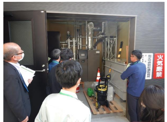
【ペレットボイラー見学】
