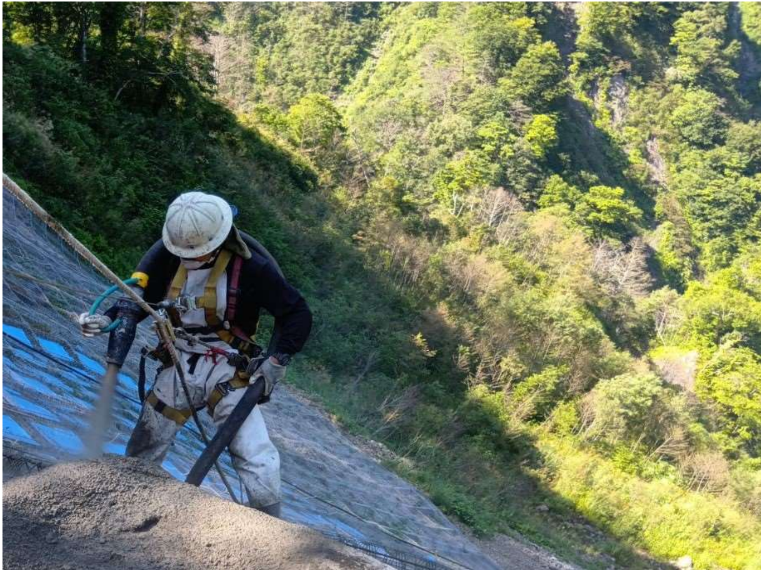
ウド川復旧治山工事 簡易法砕工モルタル吹付作業(糸魚川市大所)
