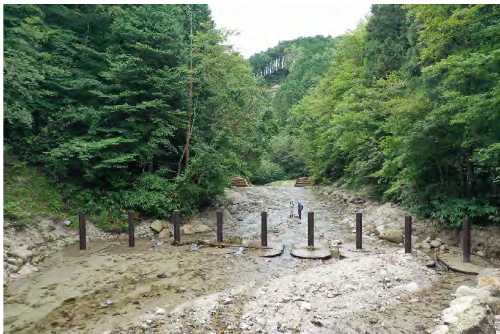
独立基礎型流木捕捉工と周辺の溪畔林
